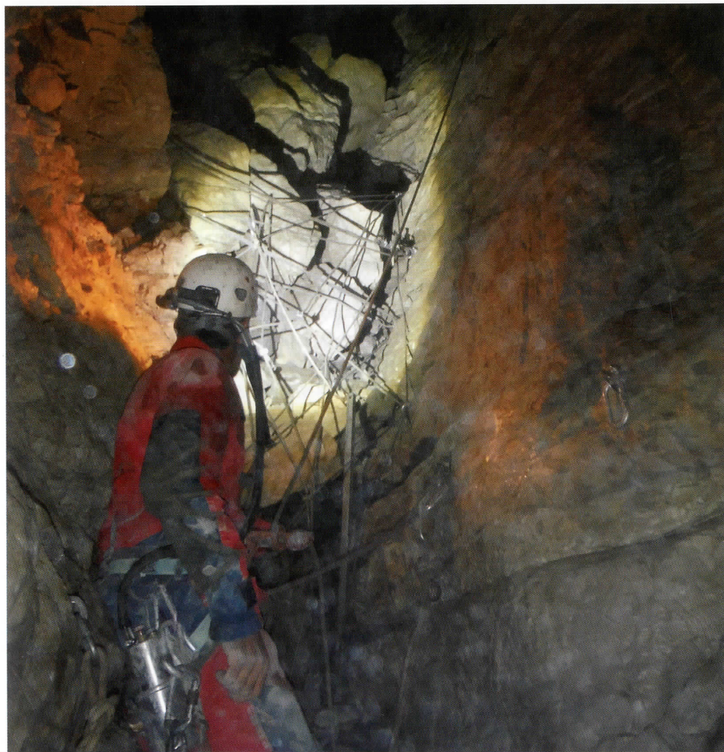
Frana imbrigliata sul grande pozzo
